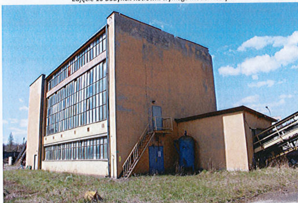
Zdjęcie 10 Budynek Kotłowni wymaga modernizacji
